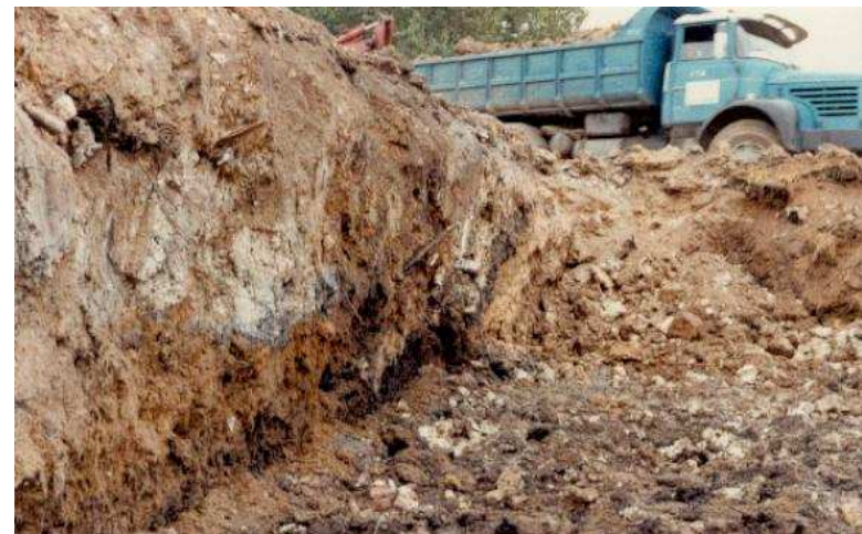
1969/70 Z.I de Lagny : remblaiements avec des ordures et gravois !
